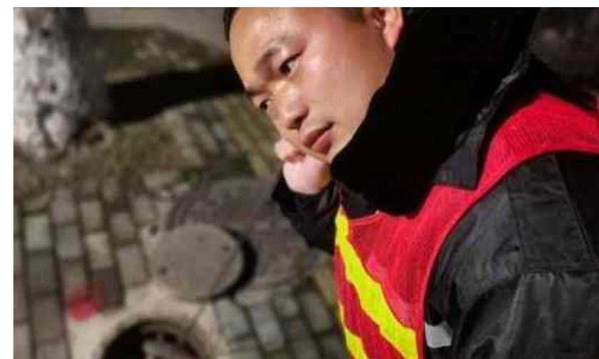
郭明羊正在排查漏点
