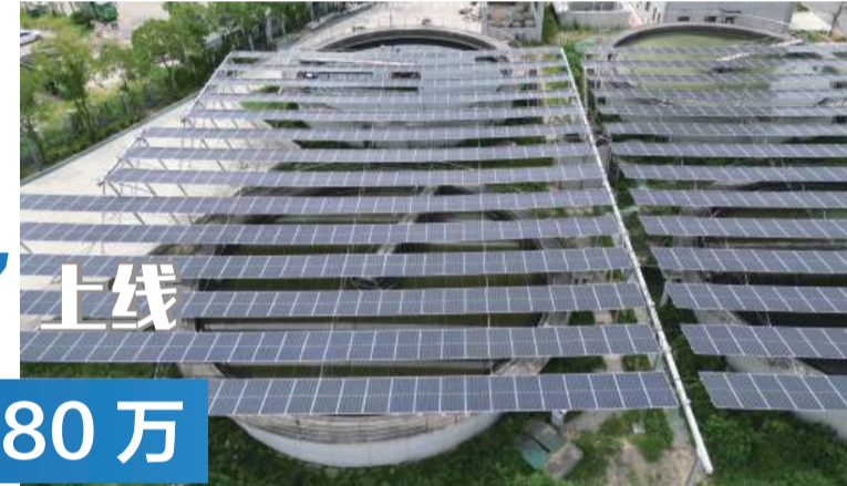
太阳能光伏板 摄影 金剑泽
