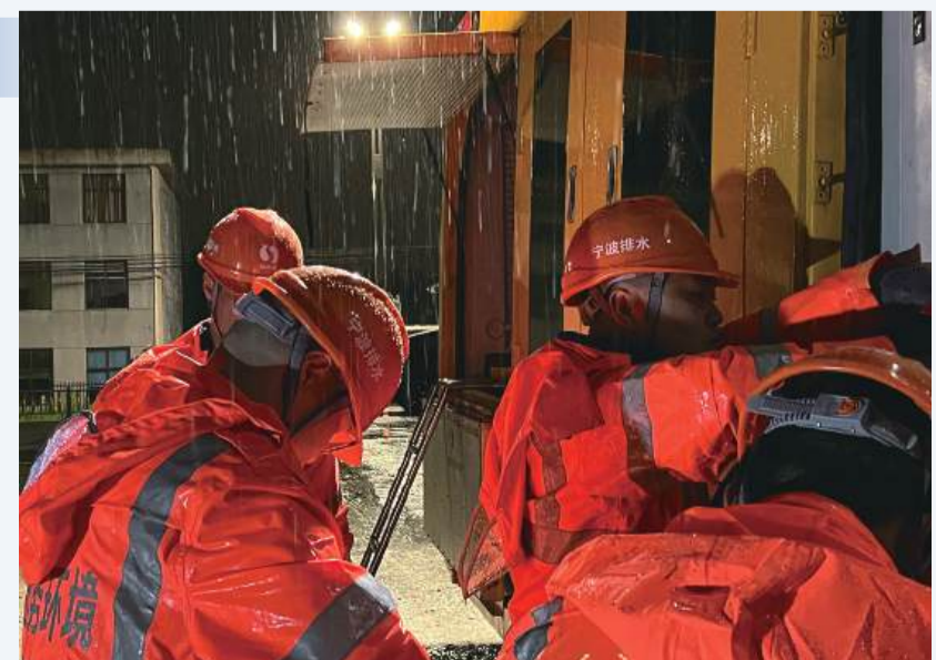
“橙青春”防汛突击队现场保障岭丰水厂DN1600出水管制接施工(摄影 林玲)
